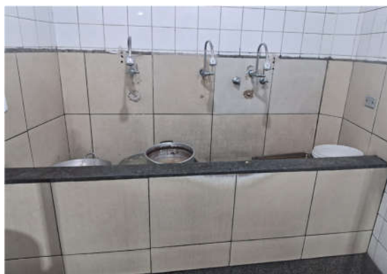
Figura 7: Novas torneiras na área de higienização das panelas.
